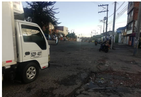
Fotografía 1: Deterioro de la carpeta asfáltica del tramo vial de la Kr 3 este entre la AC 22 y CL 22 bis sur de la calzada oriental sentido sur-norte que hace que se reduzca la velocidad generando pérdida del tiempo de verde efectivo programado para los movimientos sur – occidente, sur – norte y sur – oriente (grupos 2 y 6).
