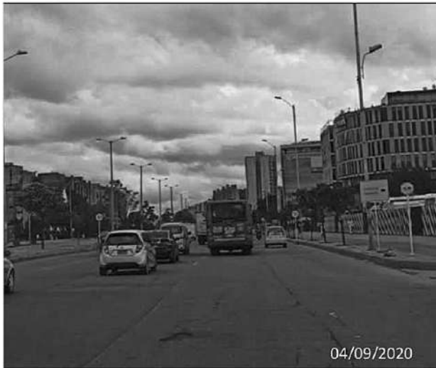
Fotografía 1. Pavimento en regular estado en la AK 72 entre CL 147 y CL 152B. Vista al norte.
