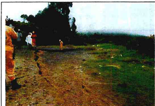
Fotografía 4. Escarpe del Talud vial en la Carrera 15 Este entre Calle 90D Sur y 91B Sur, (28 Junio 2019).
