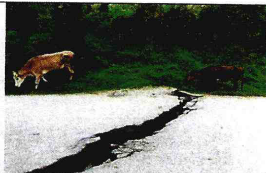
Fotografía 9. Grietas en la Carpeta de la vía en la Carrera 15 Este entre Calle 90D Sur y 91B Sur. (02 Julio 2019).
