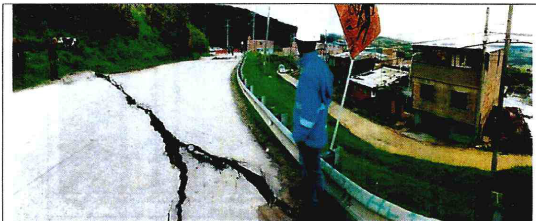
Fotografía 6. Grietas sobre la vía de la Carrera 15 Este entre Calle 90D Sur y 91B Sur, en el Barrio Juan José Rondón de la Localidad de Usme.
