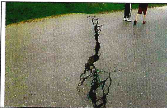
Fotografía 8. Grietas en la Carpeta de la vía en la Carrera 15 Este entre Calle 90D Sur y 91B Sur. (28 Junio 2019).
