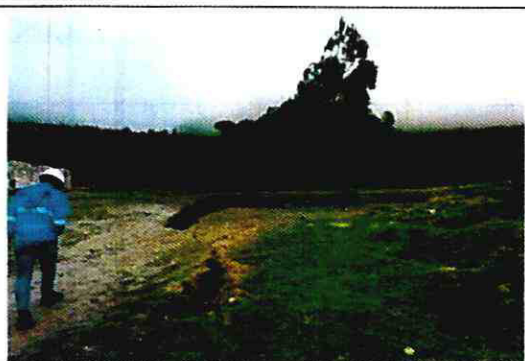
Fotografía 5. Escarpe del Talud vial en la Carrera 15 Este entre Calle 90D Sur y 91B Sur, (02 Julio 2019).
