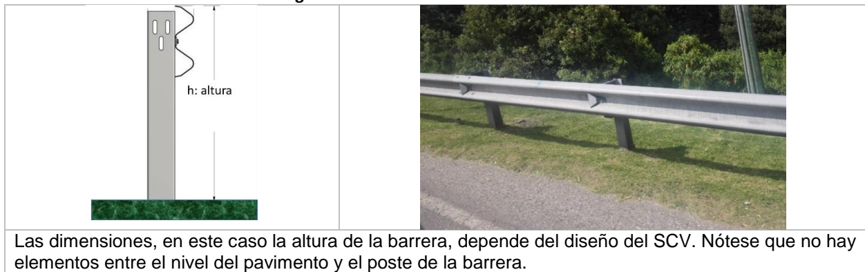
Figura 15. Altura de la defensa metálica.
