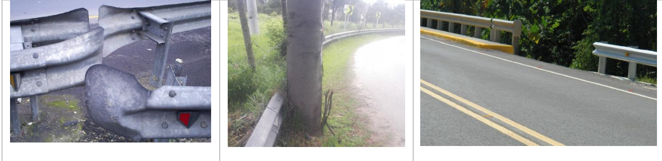
Figura 20. Errores de no-continuidad de la defensa metálica.
