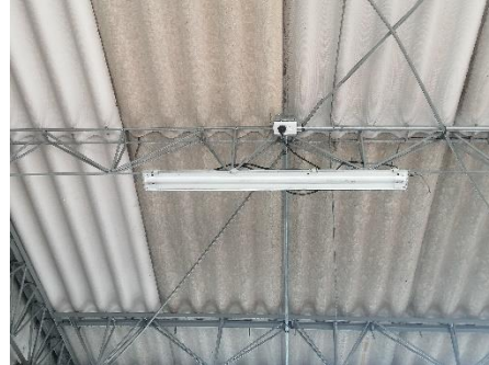
Luminarias apagadas en bodegas almacén
