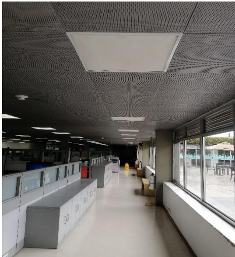
Luminarias suspendidas en pasillos
