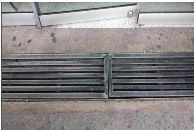
Zona de Ingreso CI 13 Punto de Servicios
