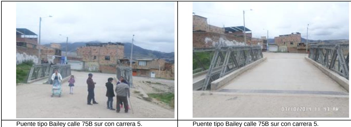
Puente tipo Bailey calle 75B sur con carrera 5.
