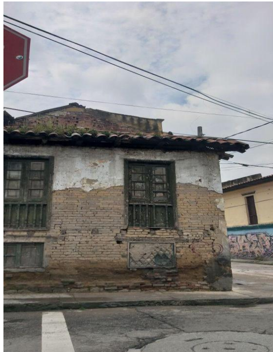
Fotografía 30. Deterioro de vivienda en el barrio Las Cruces.
