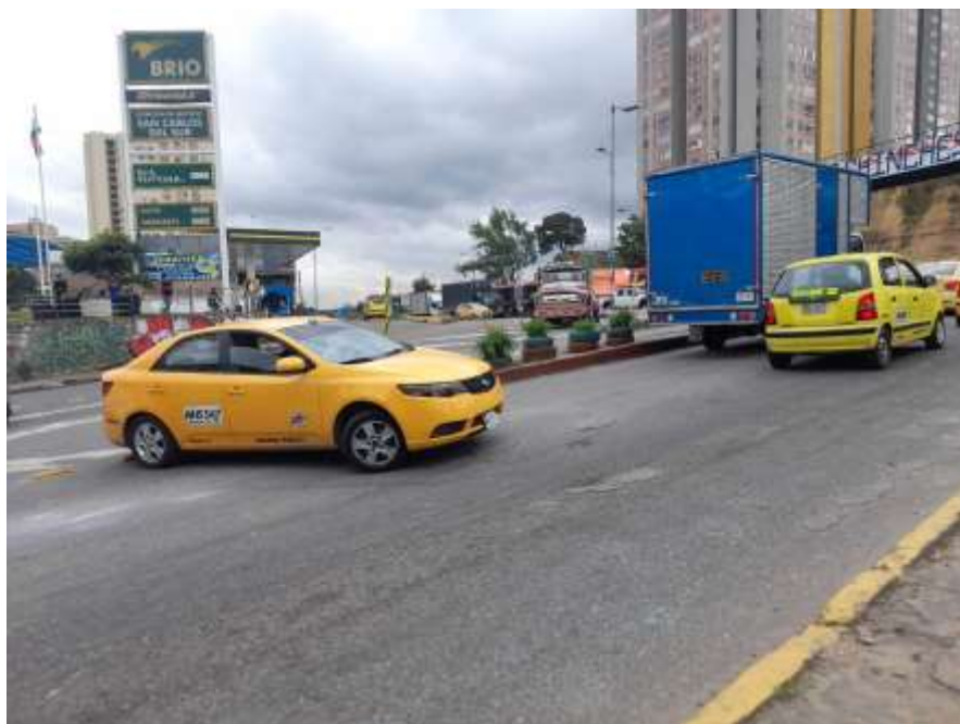
Figura 58. Estado de los andenes y demarcación en el cruce de la Av. Caracas a la altura de la Diagonal 51 B sur
