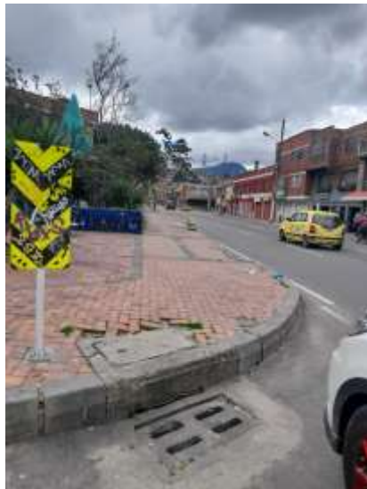
Ausencia de rampas en las esquinas
