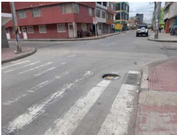
Pozo con tapa hundida a la altura de la carrera 15
