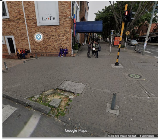
Foto 4: Imagen de referencia 20 febrero 2025, donde se evidencia estado de la válvula del acueducto
