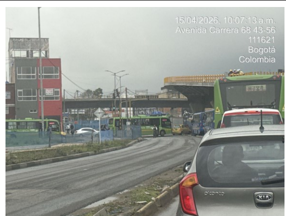
Fotografía 4. Av. Carrera 68 con Calle 43 Sur, formación de colas vehiculares, asociada a la reducción temporal de capacidad vial por obras de conexión con la Autopista Sur
