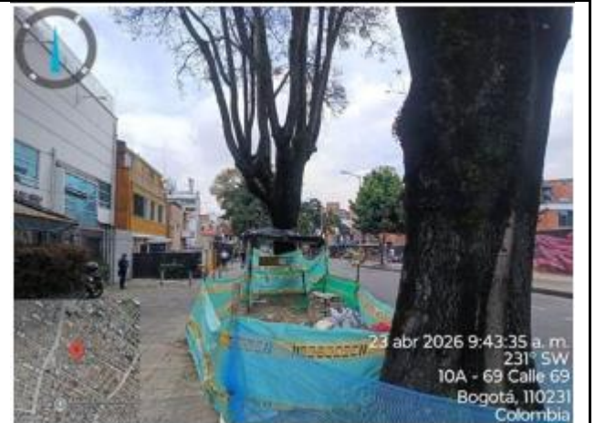
Foto 4: Calle 69 cerramientos de materiales RCD
