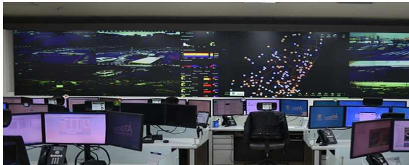
Imagen 1. Implementación de apoyo Centro de Gestión de Tránsito. Fuente (SDM-SGV)
