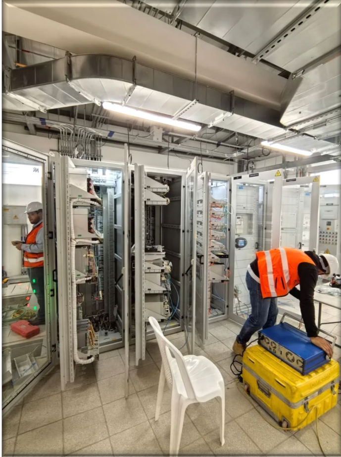
Pruebas internas SER 1 para la integración con la subestación El Porvenir (ENEL).
