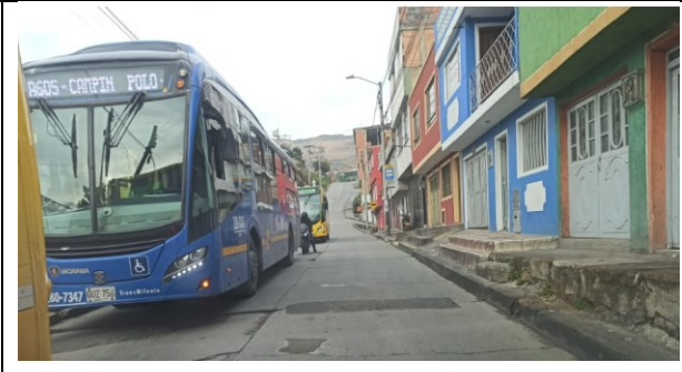
Fotografía 4. Deterioro en reductores de velocidad en la Carrera 20 C.
