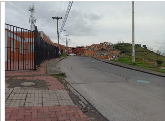
Fotografía 5. Deterioro en la malla vial en la Carrera 20 C (sentido norte – sur).
